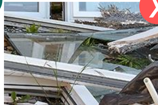
Fenêtres avec vitrage cassé
